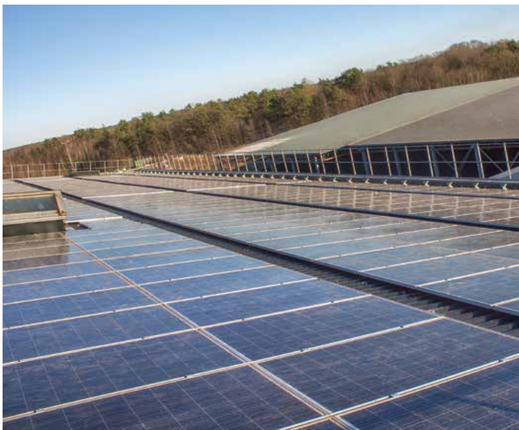
Solcellspaneler på taket av VMAB:s kvarnbyggnad. Solenergi blir allt viktigare även för kommunala fastighetsförvaltare och bolag.
